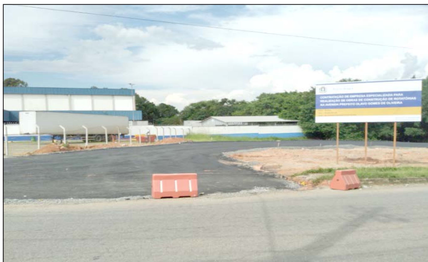
ROTATÓRIA DO ABC OBRA LICITADA A MUITO TEMPO E QUE AGORA ESTA INDO A PASSOS DE TARTARUGA.
